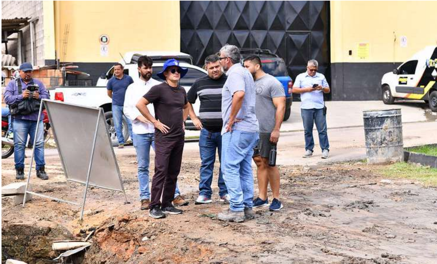
David fiscalizou os serviços de recuperação asfáltica que estão sendo realizadas na cidade
