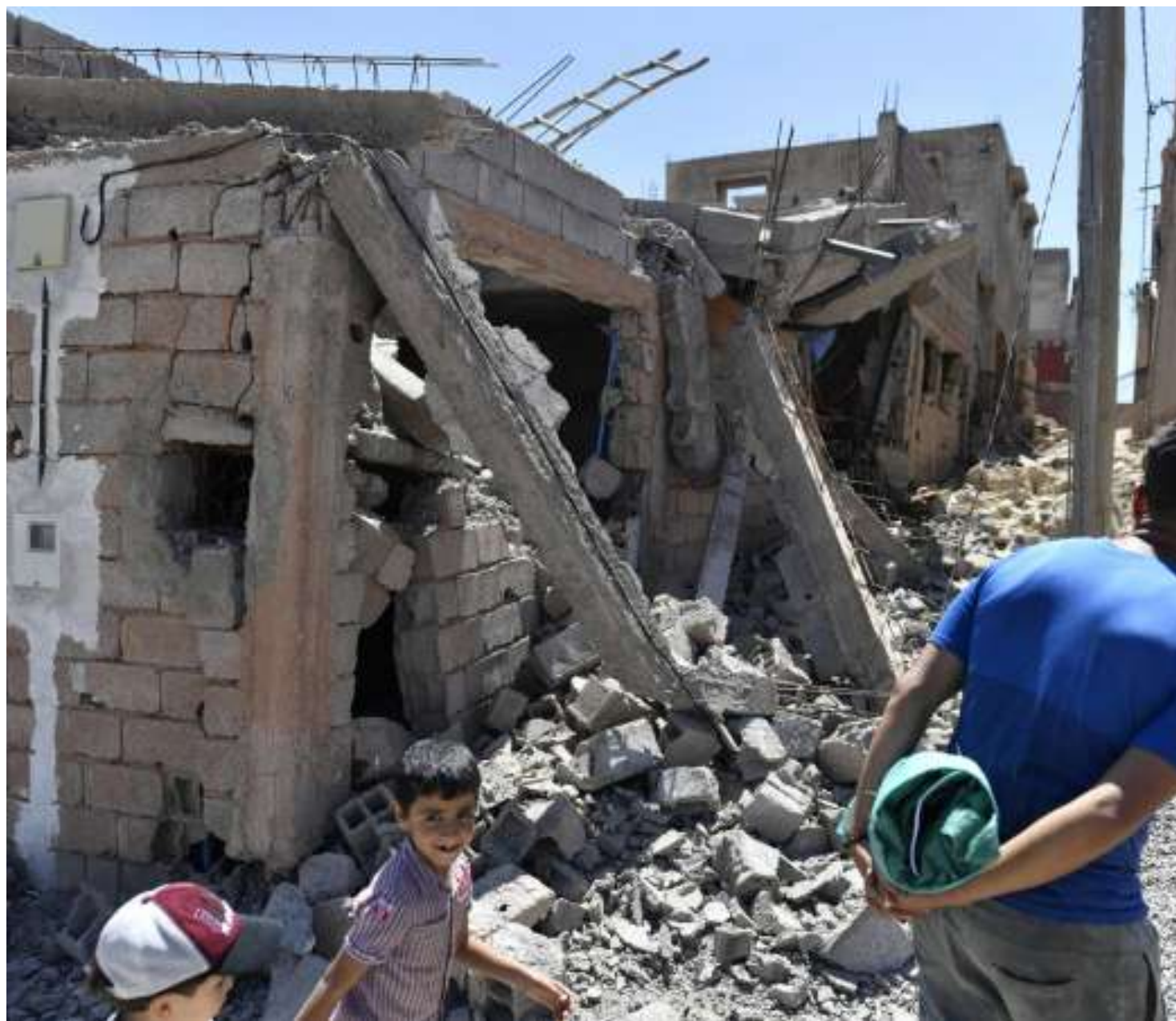
Casa destruída pelo terremoto no Marrocos (NHK)
