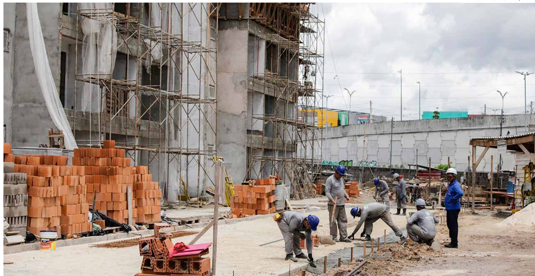
Construção de habitacionais do programa 'Amazonas Meu Lar', do Governo do Estado
