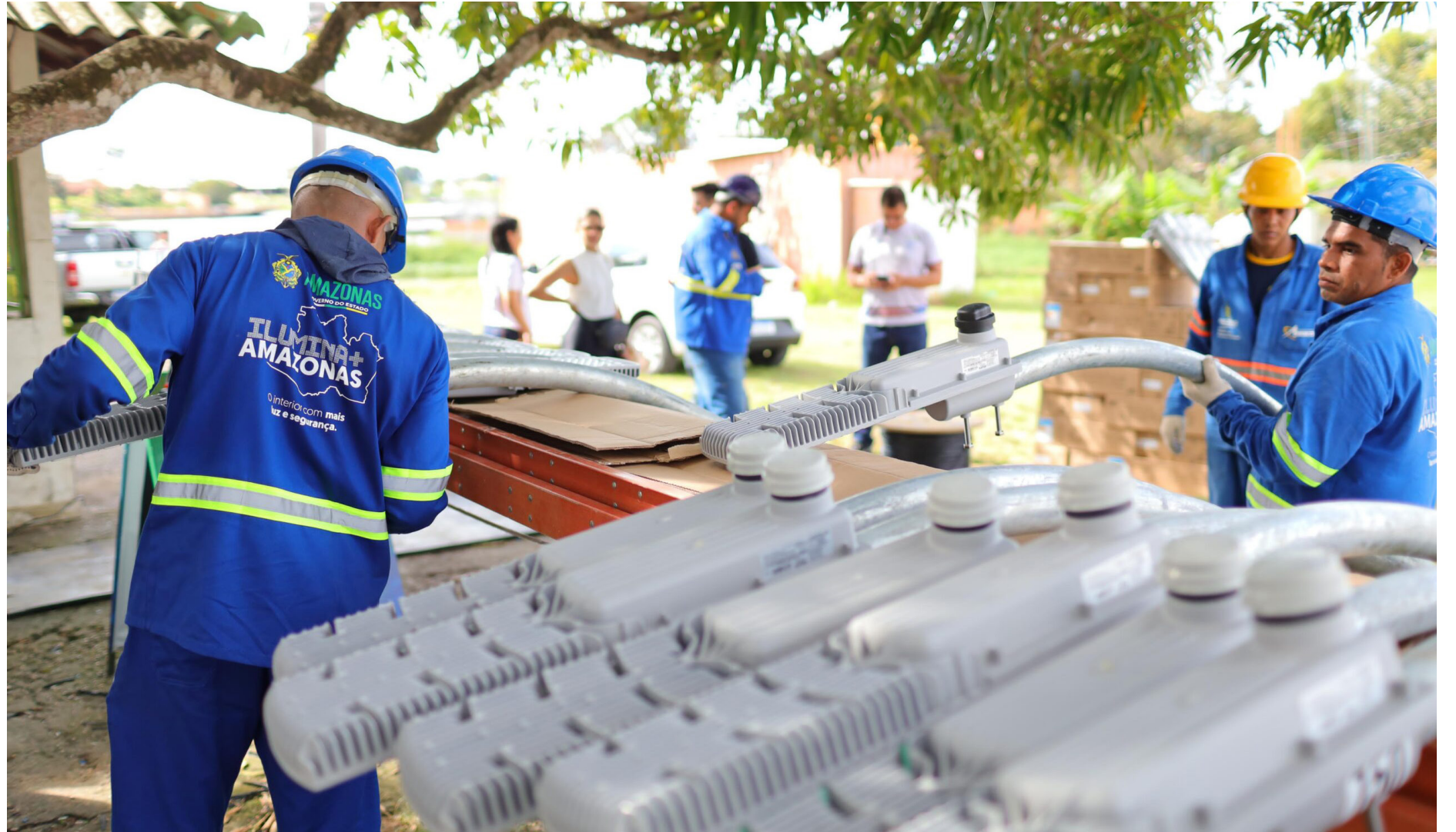
Modernização do sistema de iluminação pública em 81 comunidades de Parintins (a 369 quilômetros de Manaus)
