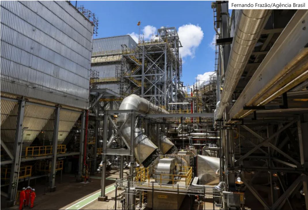
A unidade U-93, de abatimento de emissões de gases SNOX na Refinaria Abreu e Lima (RNEST), da Petrobras, transforma óxido de enxofre e óxido de nitrogênio em ácido sulfúrico, a ser comercializado
