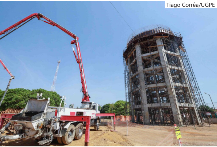
Centros de Reservação e Distribuição (CRDs)
