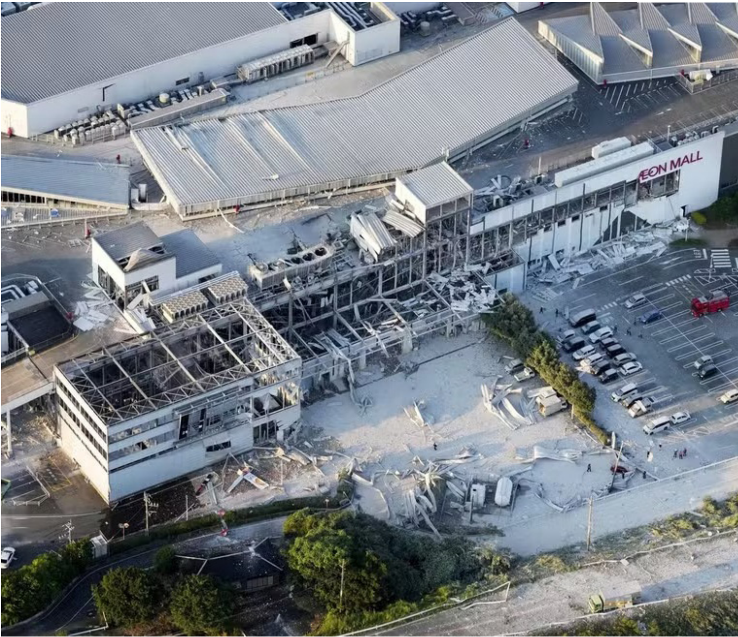
Equipes de resgate seguem em busca de sobreviventes nos escombros na região de Kumamoto, sul do país
