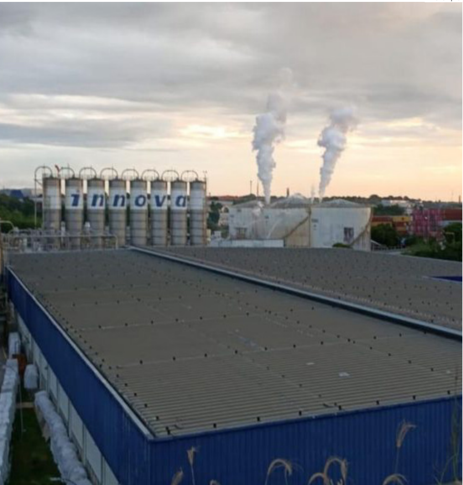
Vazamento de produto químico é registrado em empresa do Distrito Industrial em Manaus
