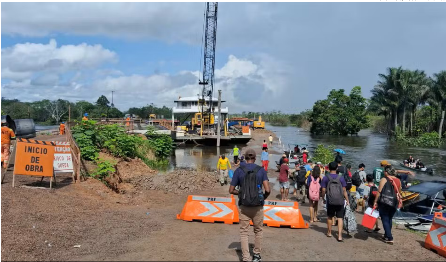
Interdição na BR-319 em 2025, no trecho da ponte que desabou sobre o Rio Curuçá
