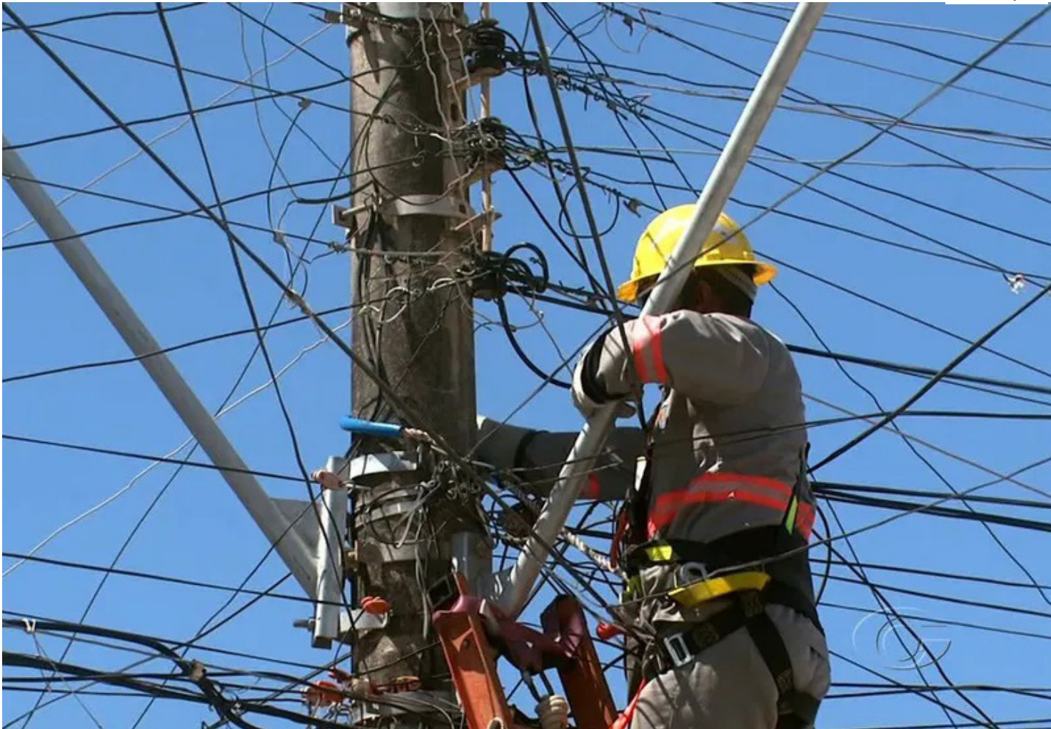
Condições da rede elétrica de Manaus
