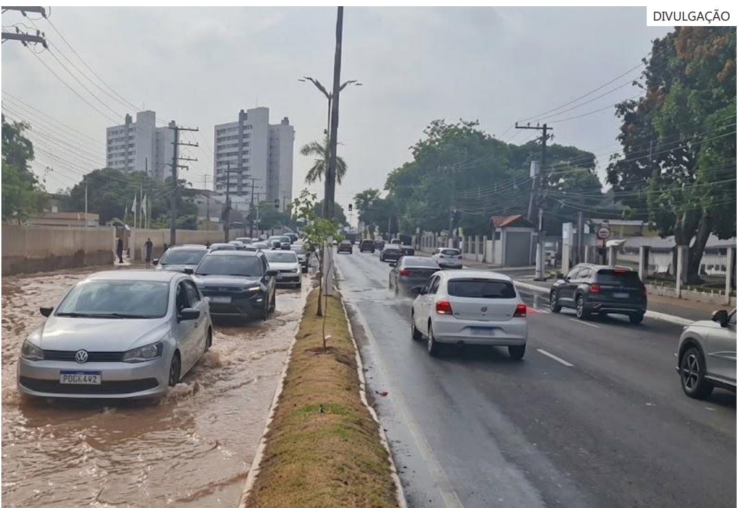
De acordo com a Águas de Manaus, reparo emergencial está em curso e deve ser concluído até o fim da tarde desta quarta-feira (16)
