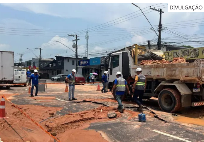
Dois vazamentos provocaram transtornos no trânsito e interrupções no fornecimento de água
